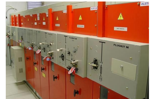
Cellules électriques du poste de livraison
