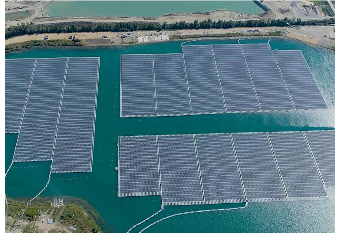
Figure 40 : Centrale Photovoltaïque Flottante Technologie « ciel et Terre » 17 MWc (Piolenc, Vaucluse)
